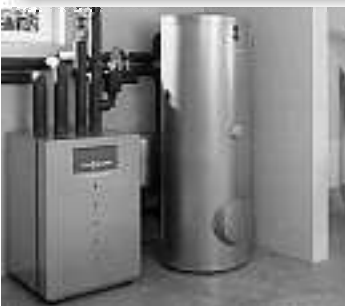
Pompe à chaleur EAU/EAU
